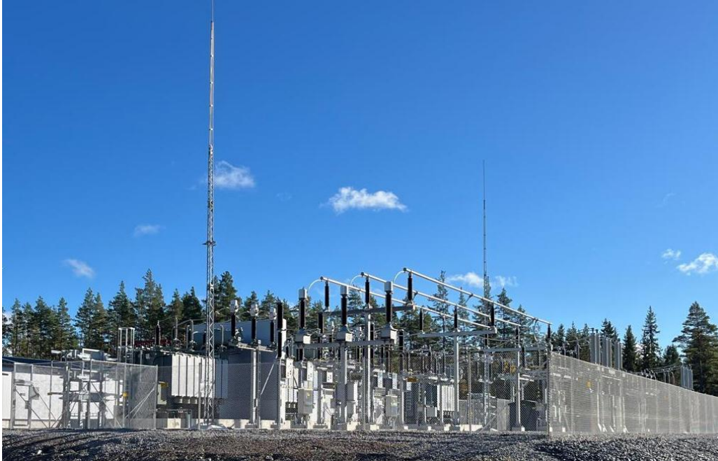
Figur 9. Exempelbild på en mottagningsstation
