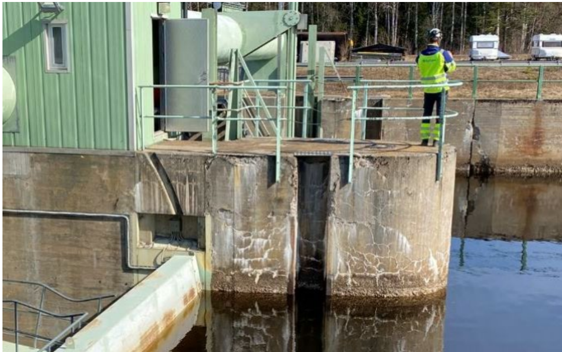
Figur 6-3 Sprickmönster med kalkutfällningar vid Storgysinge.
