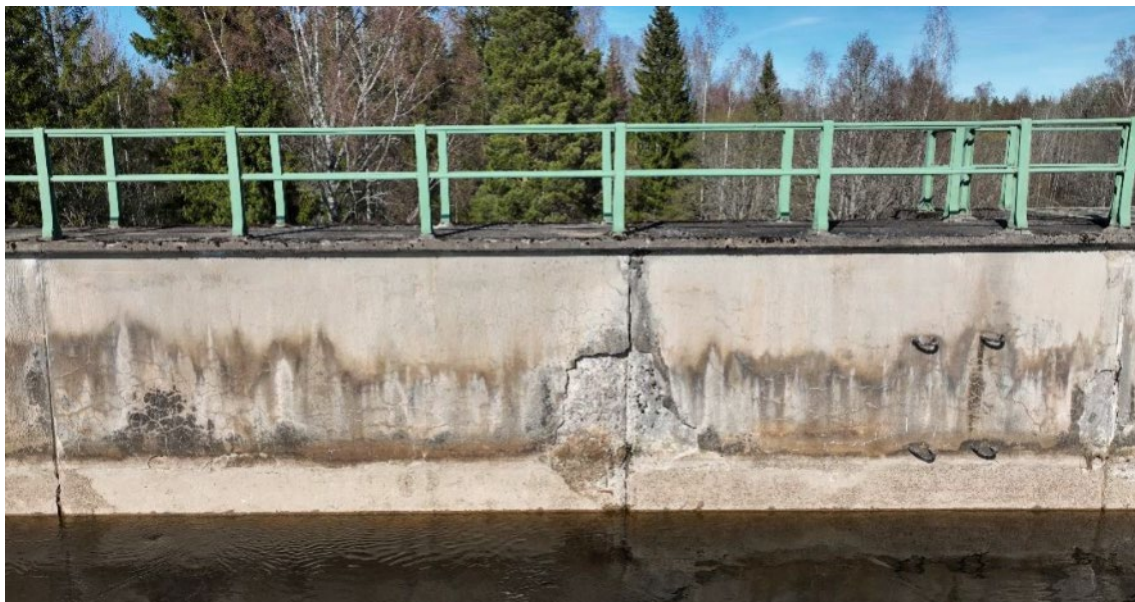
Figur 6-2 Närbild på betongskador ovan vattenlinjen
