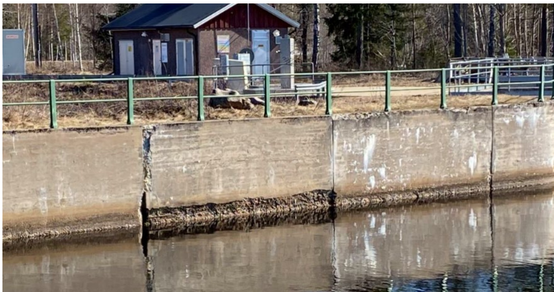
Figur 6-4 Skador i betong på höger ledmur i Storgysinge
